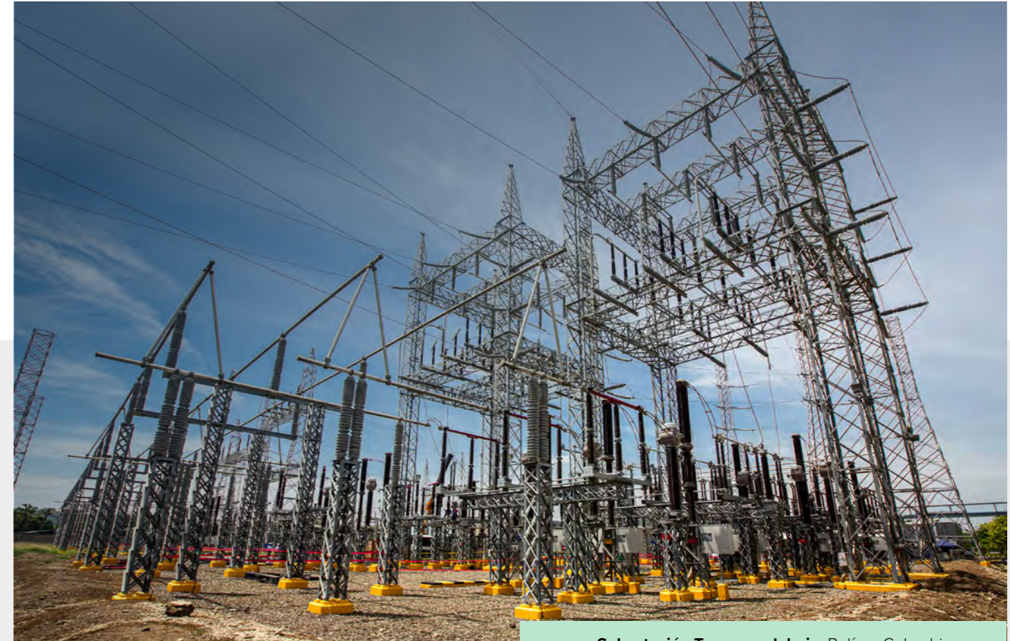
Subestación Termocandelaria, Bolívar, Colombia.
