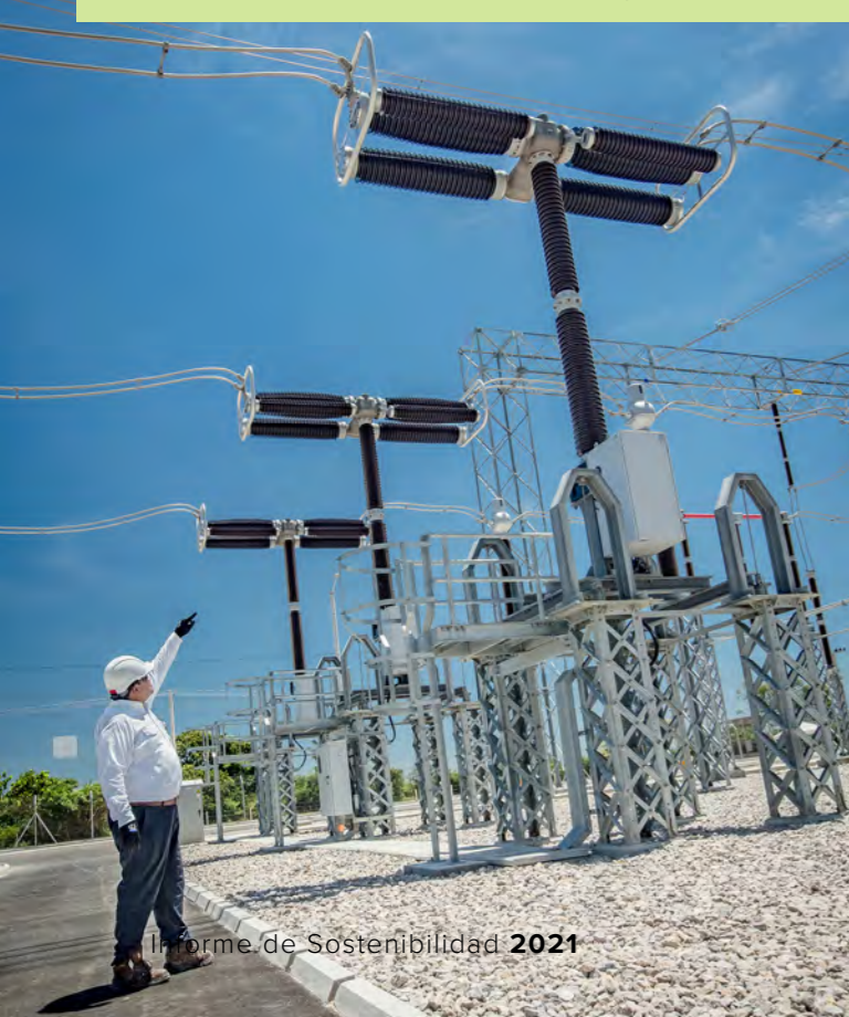
Subestación La Loma de Transmisión, Colombia
