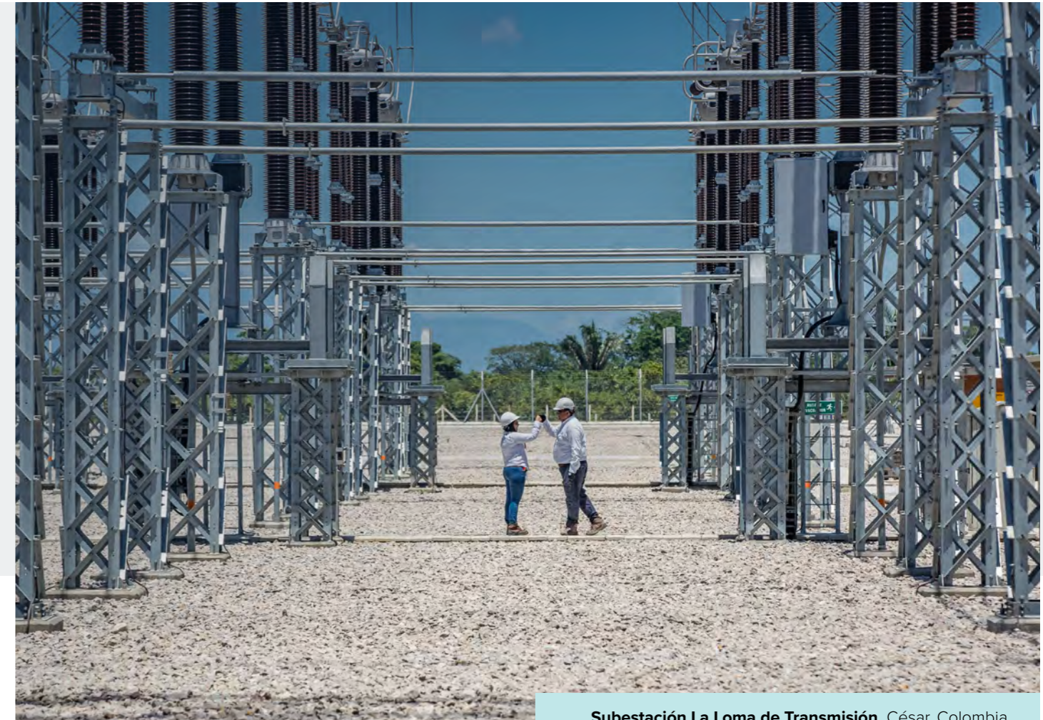
Subestación La Loma de Transmisión, César, Colombia.
