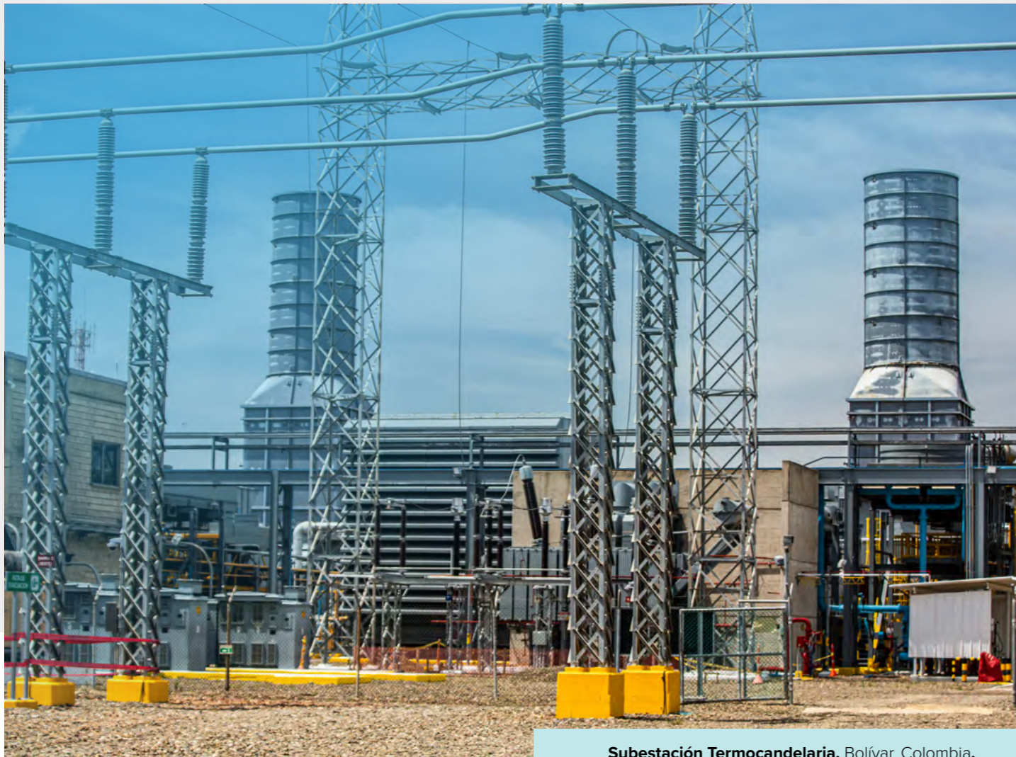
Subestación Termocandelaria, Bolívar, Colombia.
