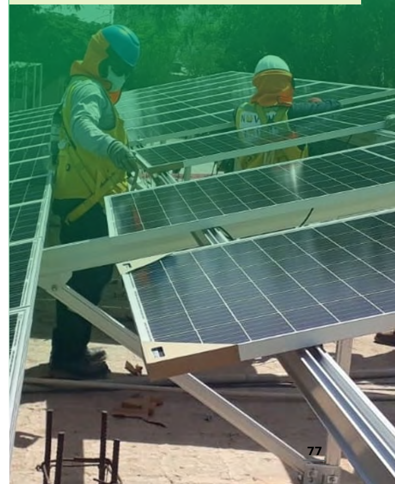
Paneles solares en TGI. La Guajira, Colombia.
