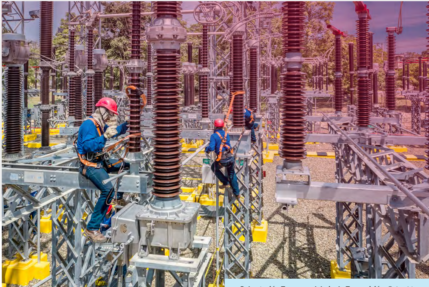
Subestación Termocandelaria de Transmisión, Colombia
