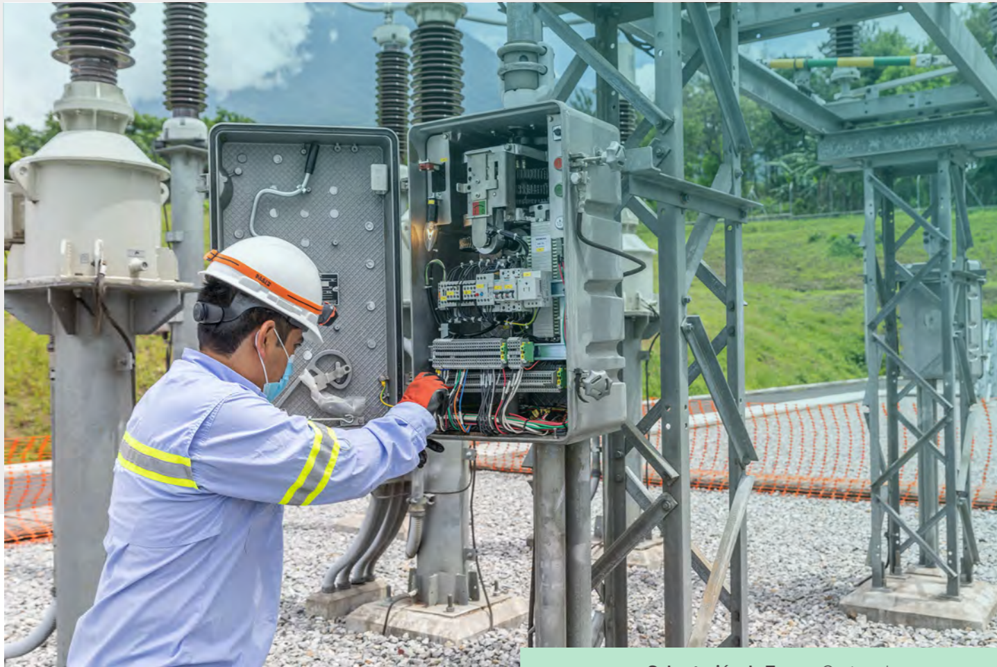
Subestación de Trecca, Guatemala.
