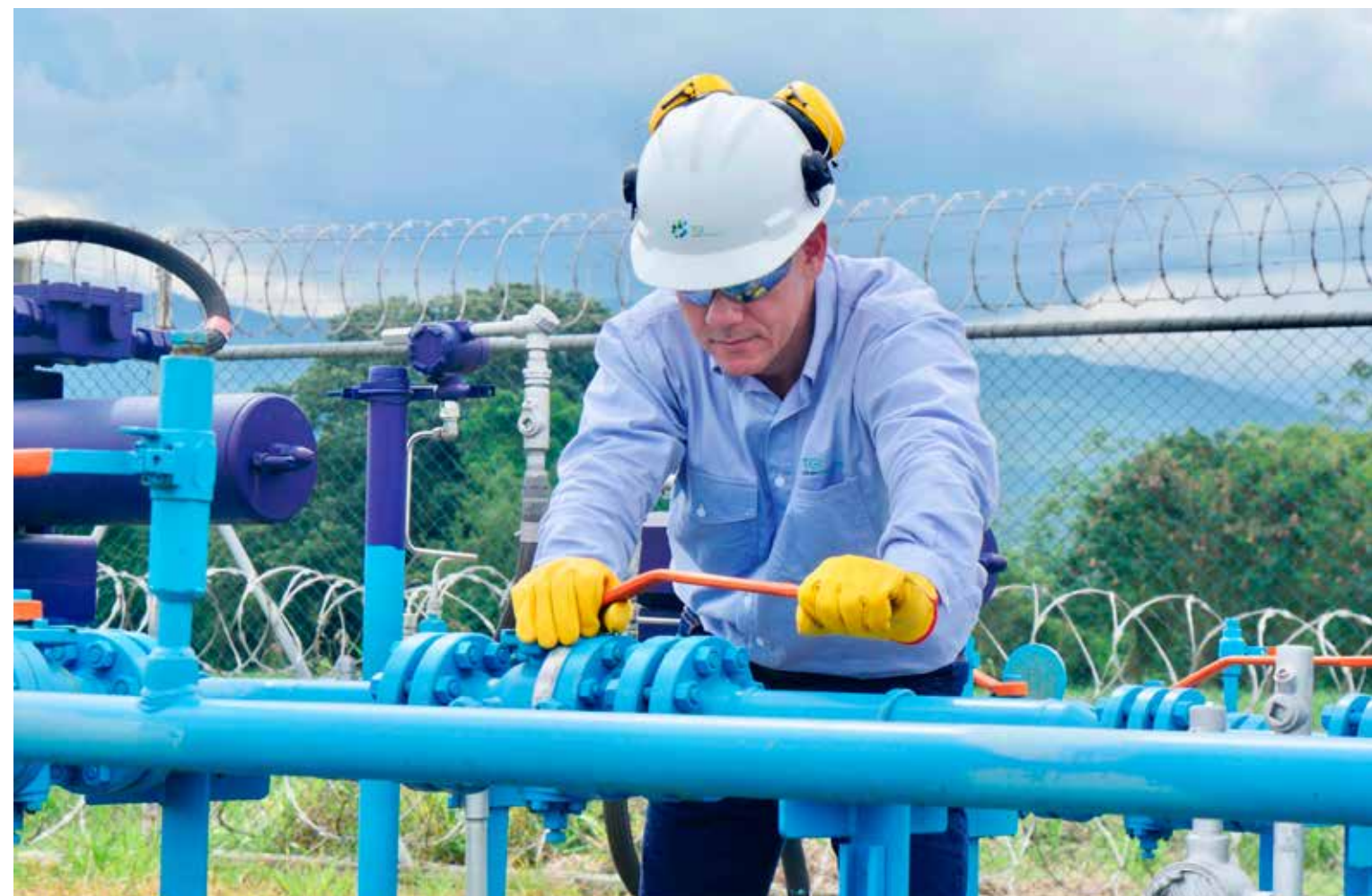
El control de emisiones desde nuestra infraestructura fue uno de los retos alcanzados en 2019
