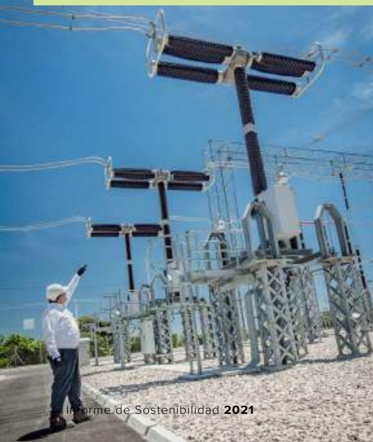
Subestación La Loma de Transmisión, Colombia
