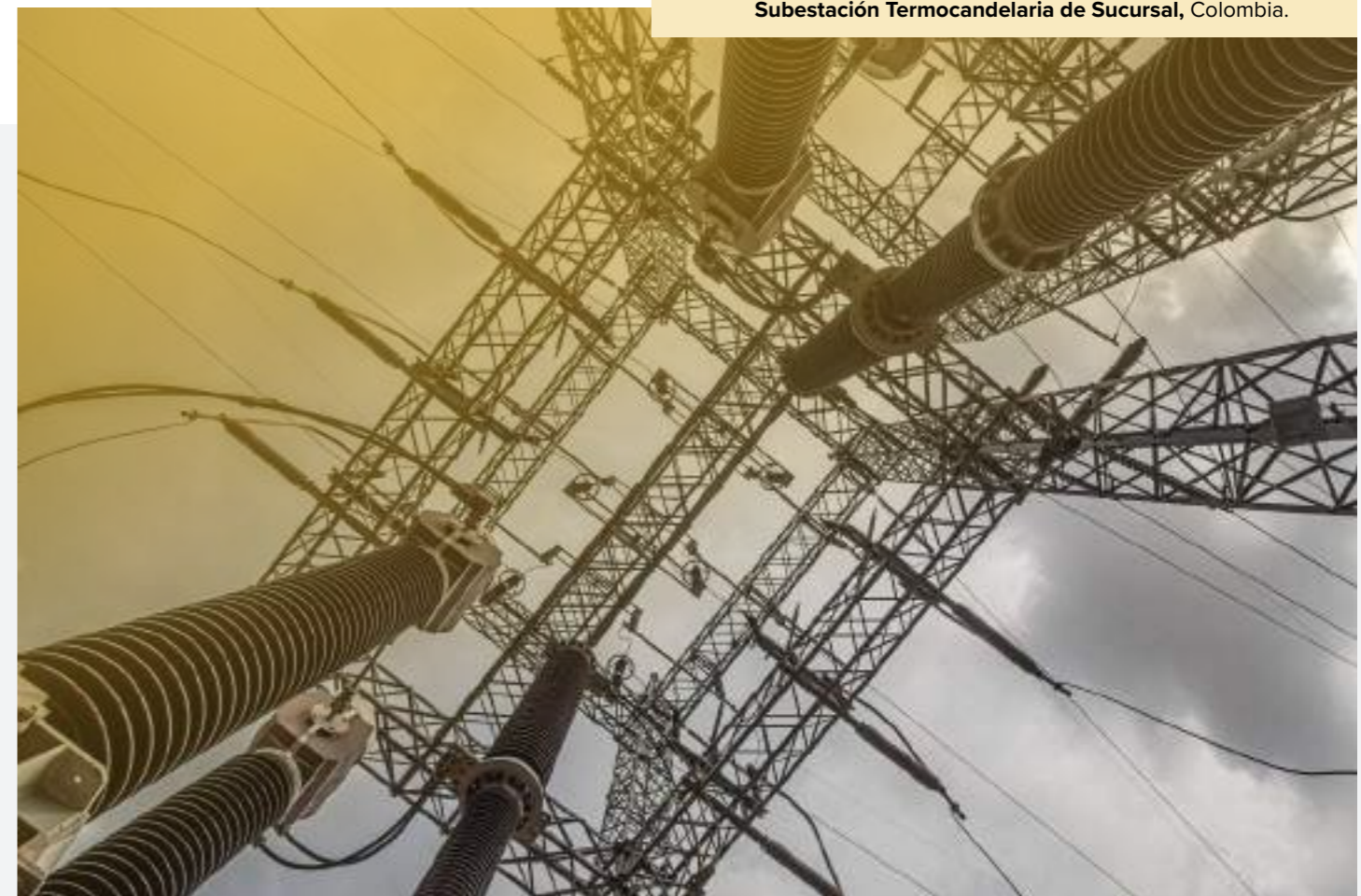
Subestación Termocandelaria de Sucursal, Colombia.
