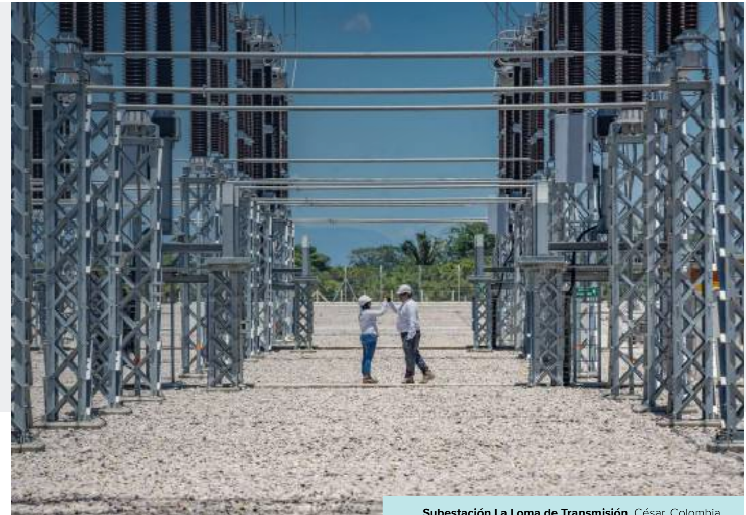
Subestación La Loma de Transmisión, César, Colombia.
