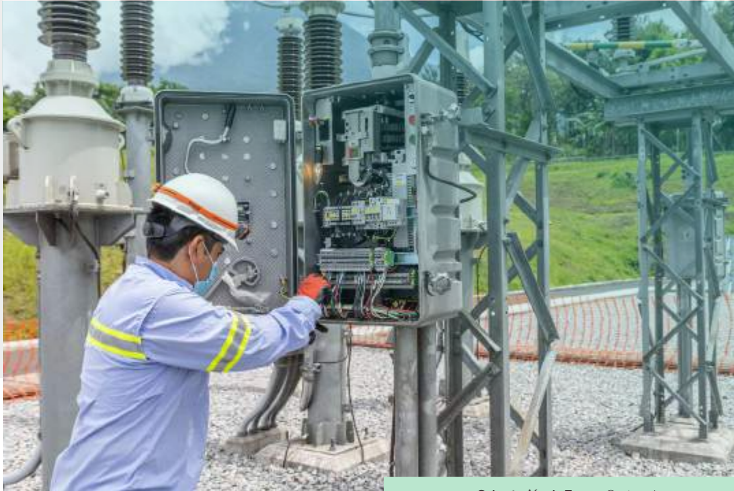
Subestación de Trecca, Guatemala.
