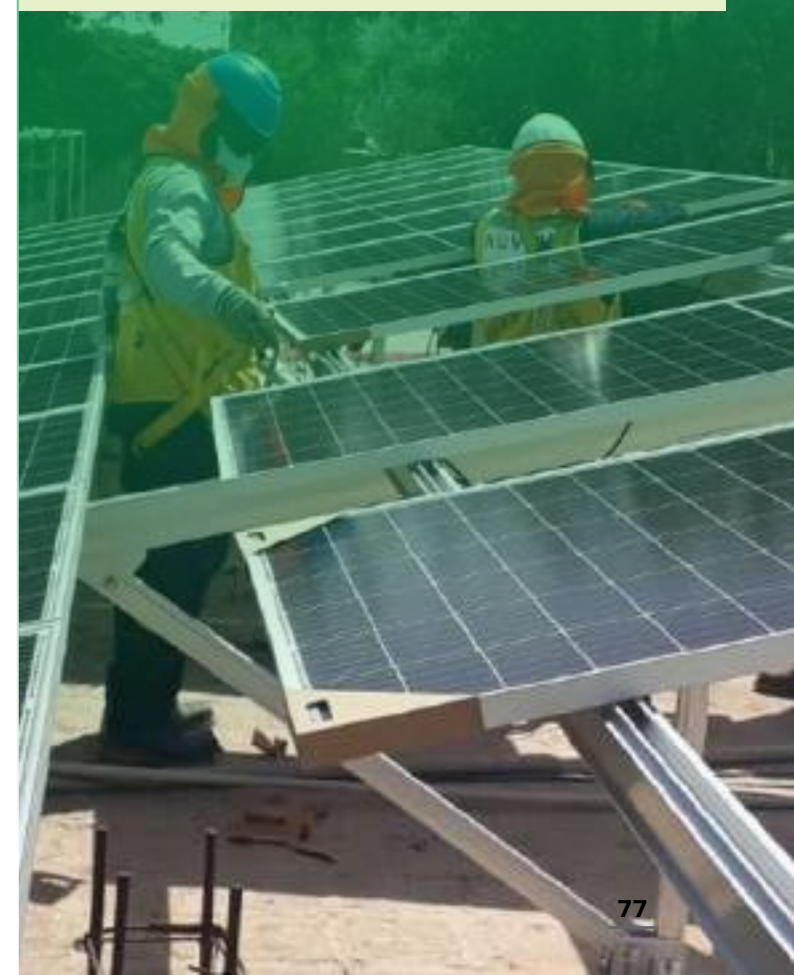
Paneles solares en TGI. La Guajira, Colombia.
