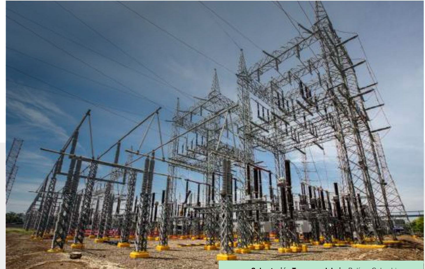
Subestación Termocandelaria, Bolívar, Colombia.
