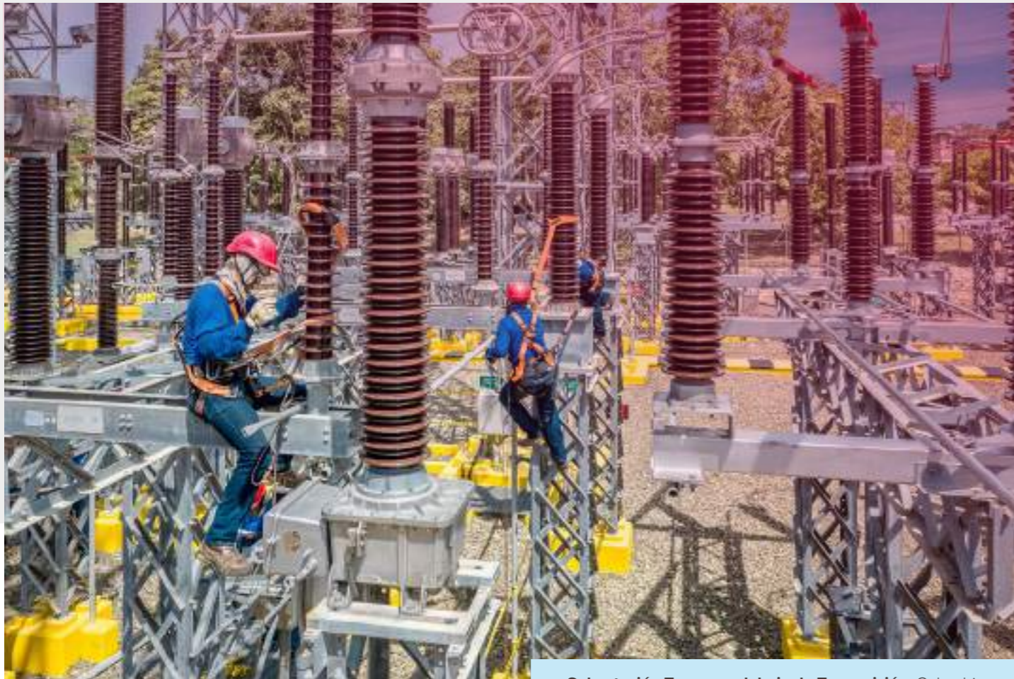
Subestación Termocandelaria de Transmisión, Colombia
