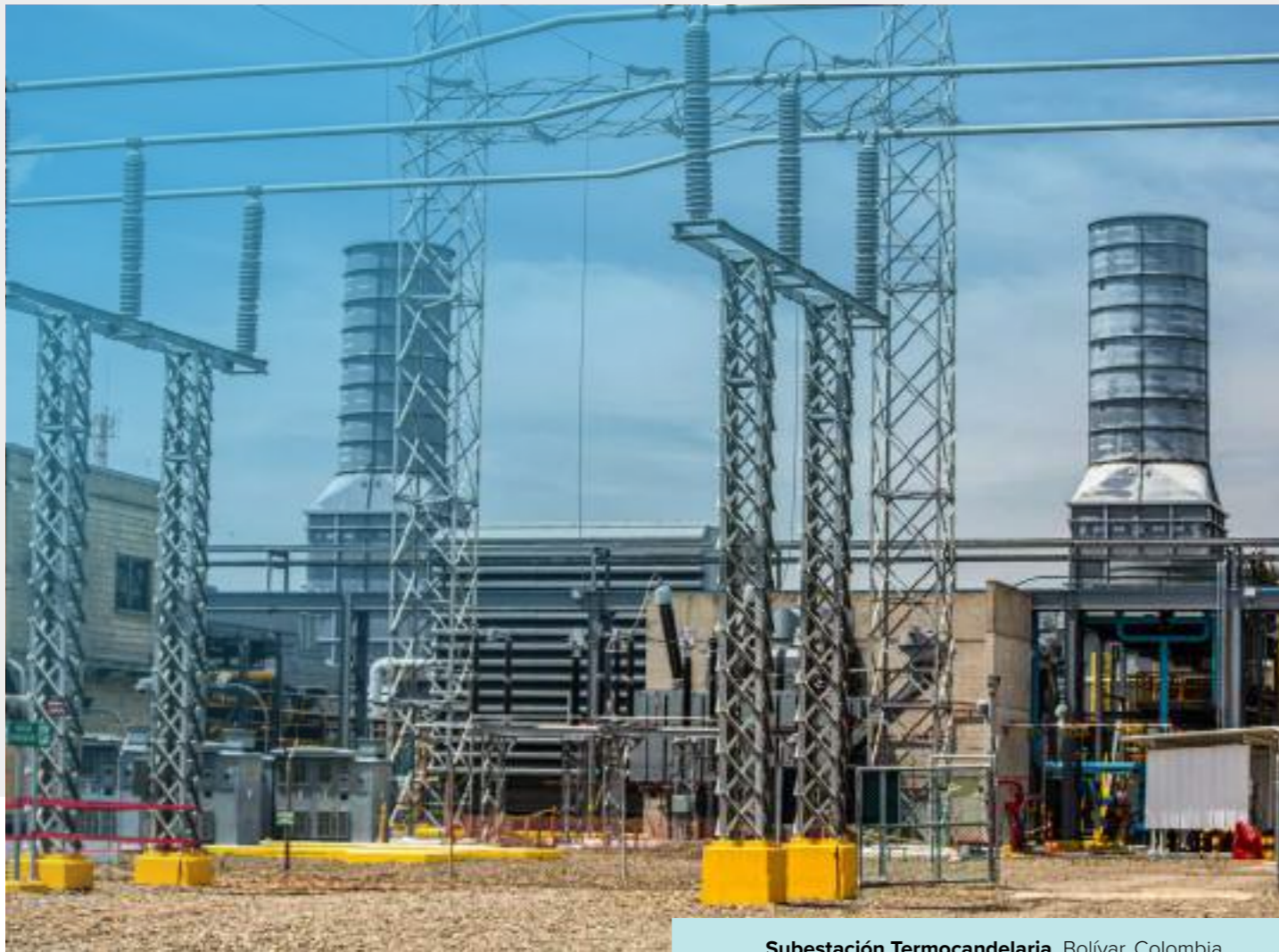
Subestación Termocandelaria, Bolívar, Colombia.
