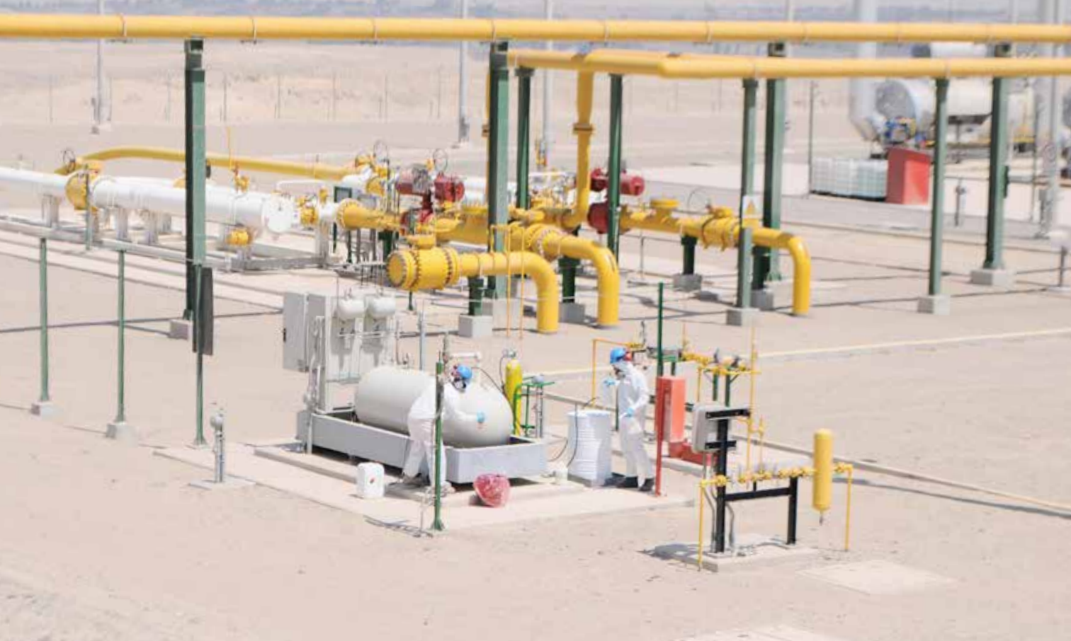
Gasoductos de Contugas, Perú.
