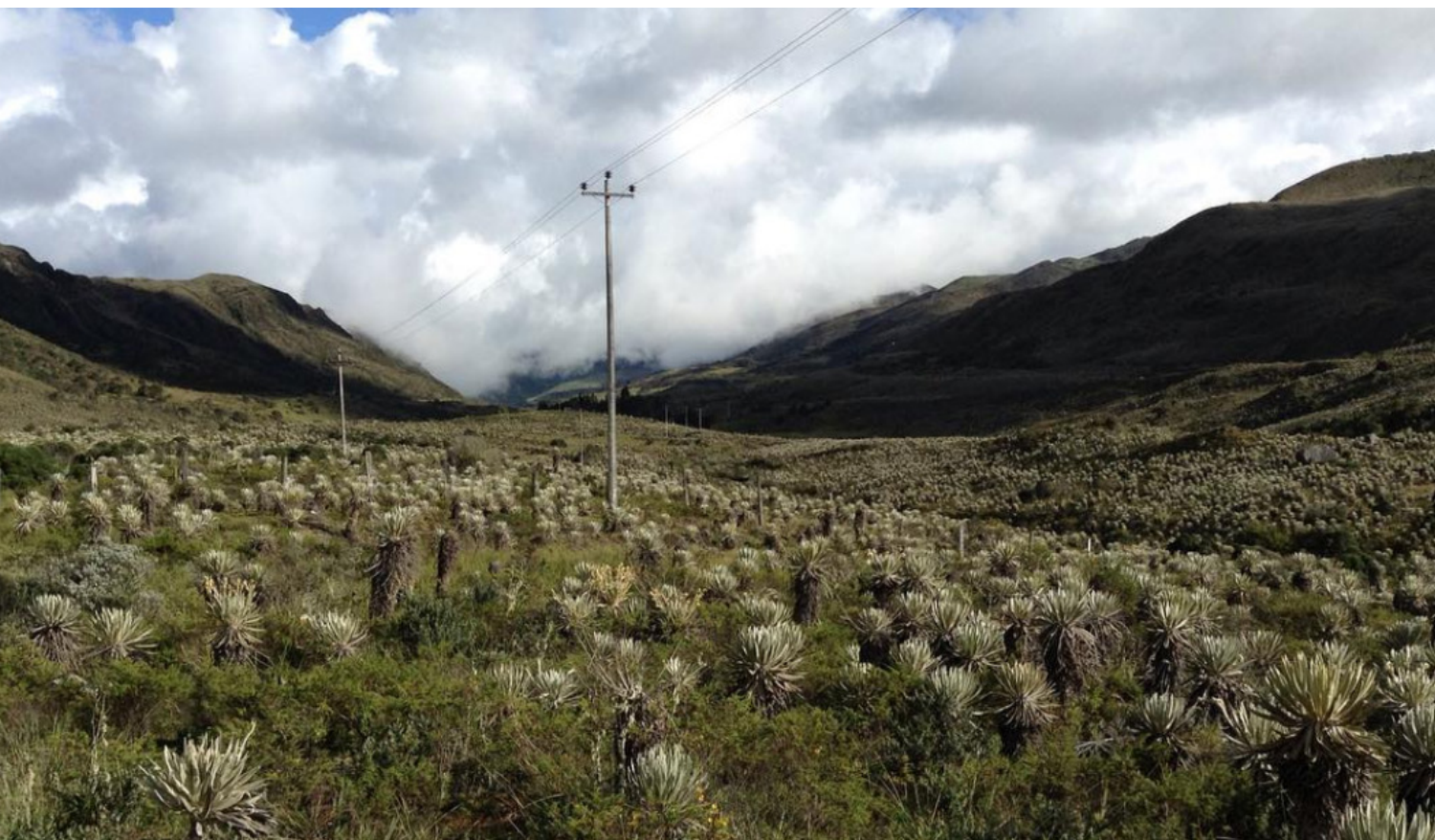
Torre de transmisión en el municipio Filandia, del proyecto Armenia entre los departamentos de Quindío y Risaralda
