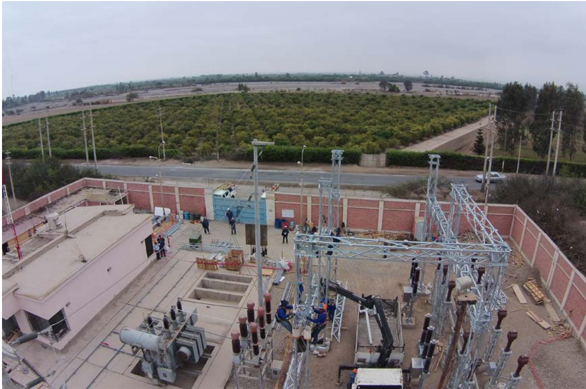
Infraestructura de Electro Dunas en Perú
