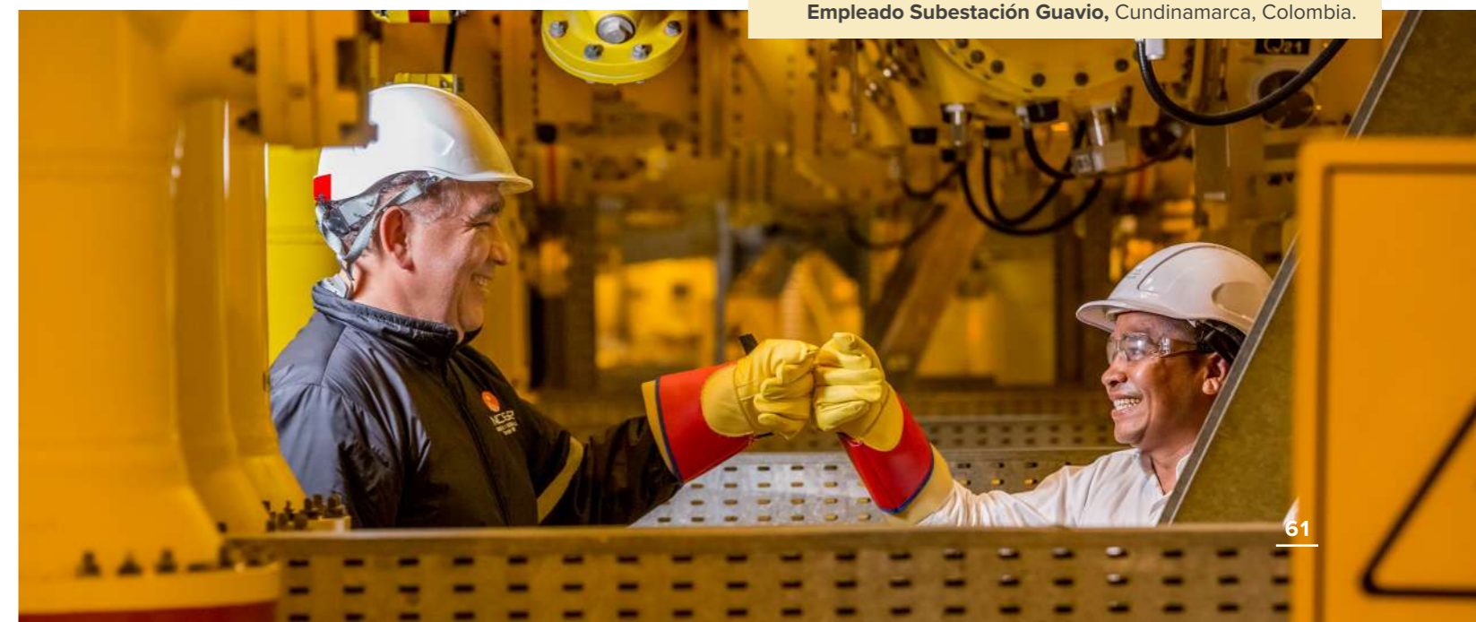
Empleado Subestación Guavio, Cundinamarca, Colombia.
