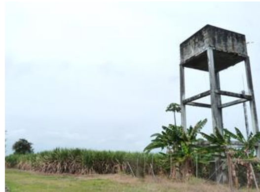
Fotografía 3-10 Vista de tanque elevado de la vereda Guali - Candelaria
