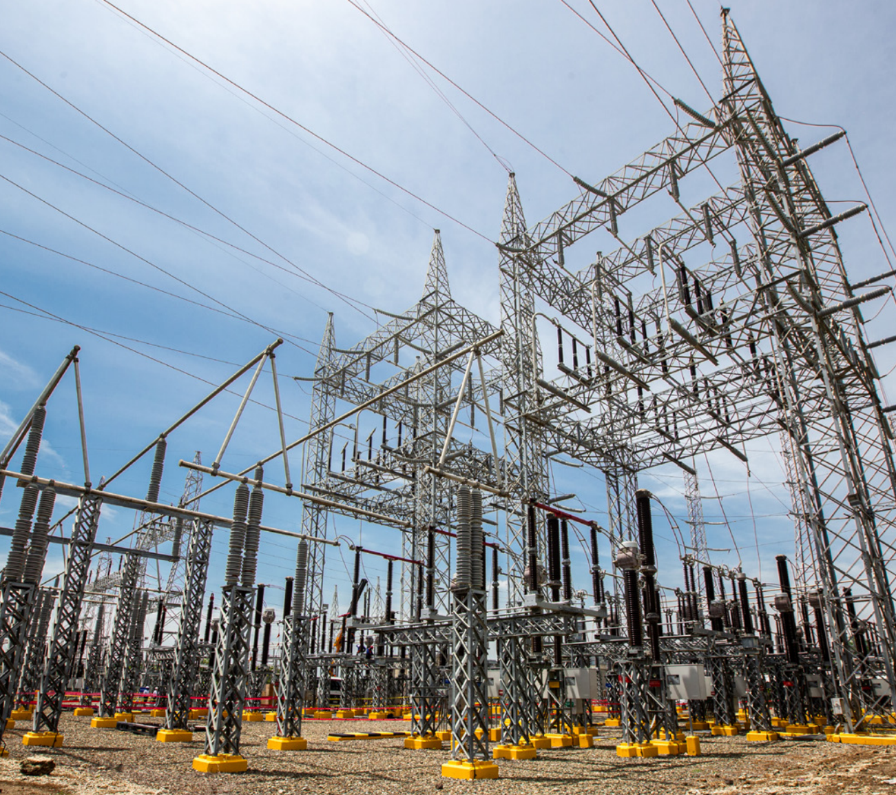
Subestación Termocandelaria. Cartagena.
