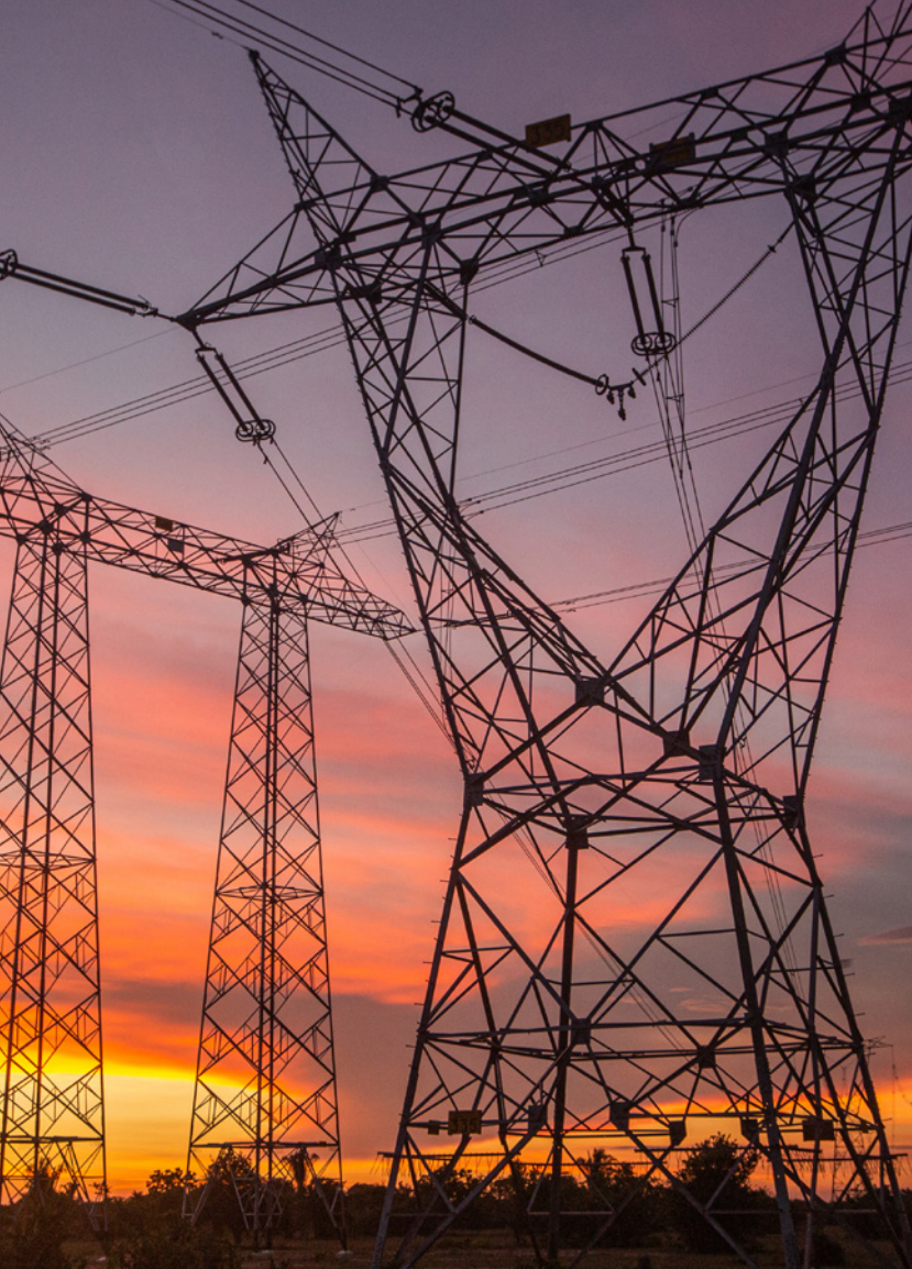
Subestación La Loma. Cesar.
