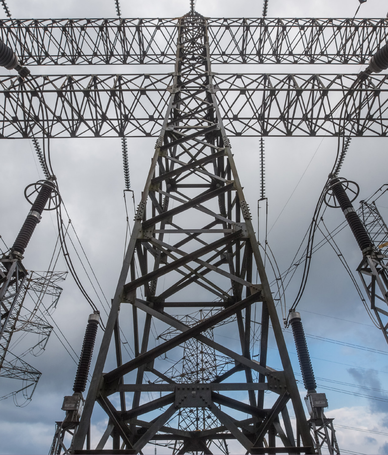
Subestación El Guavio.
