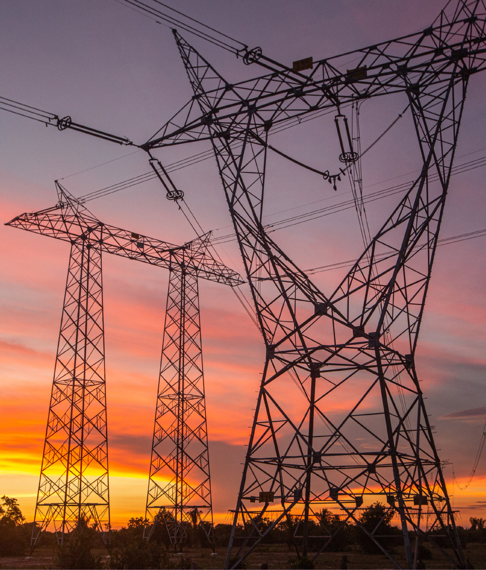
Subestación La Loma. Cesar.
