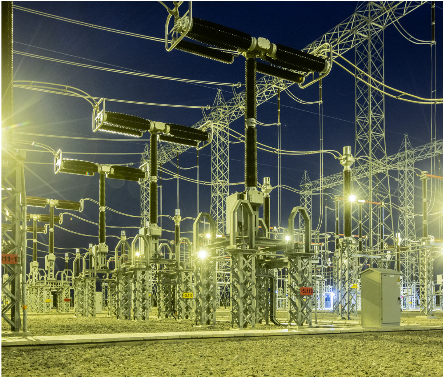
Subestación La Loma. Cesar.
