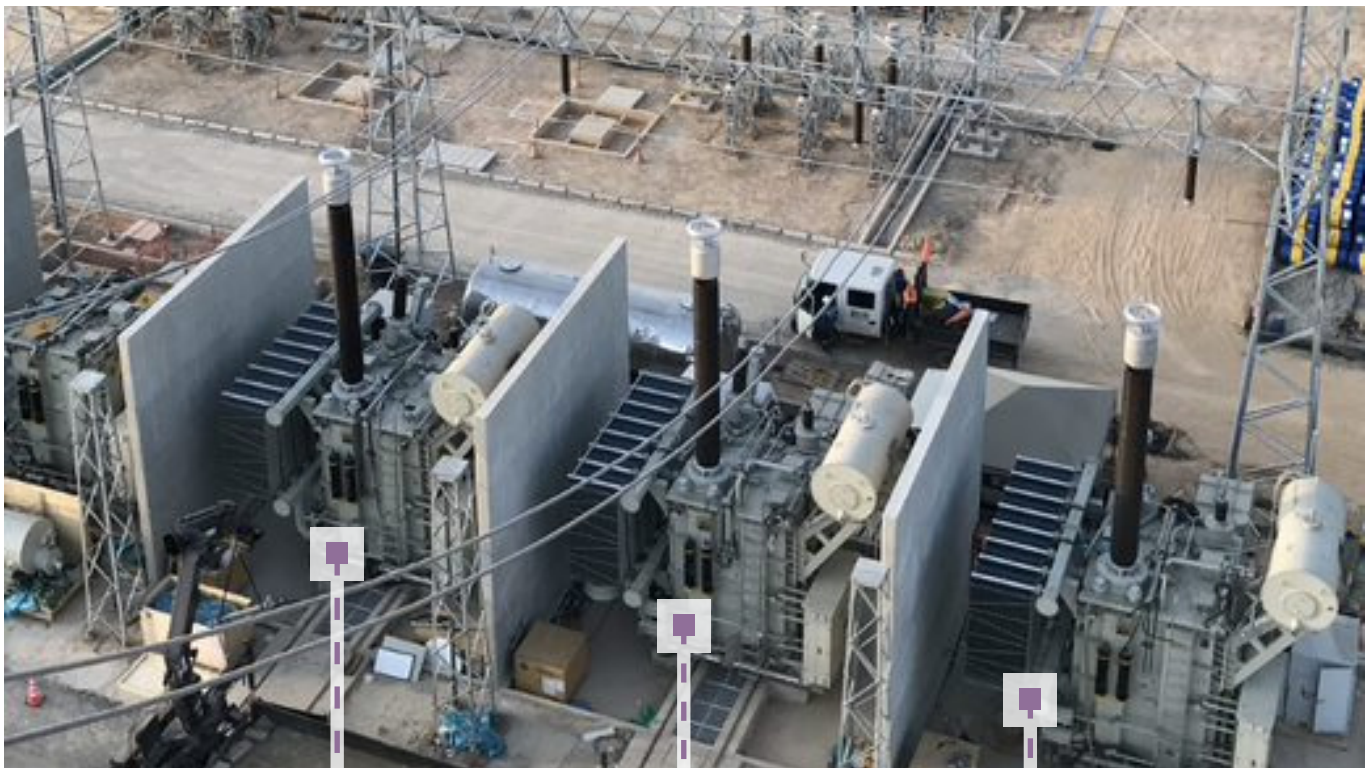
Transformadores de potencia
