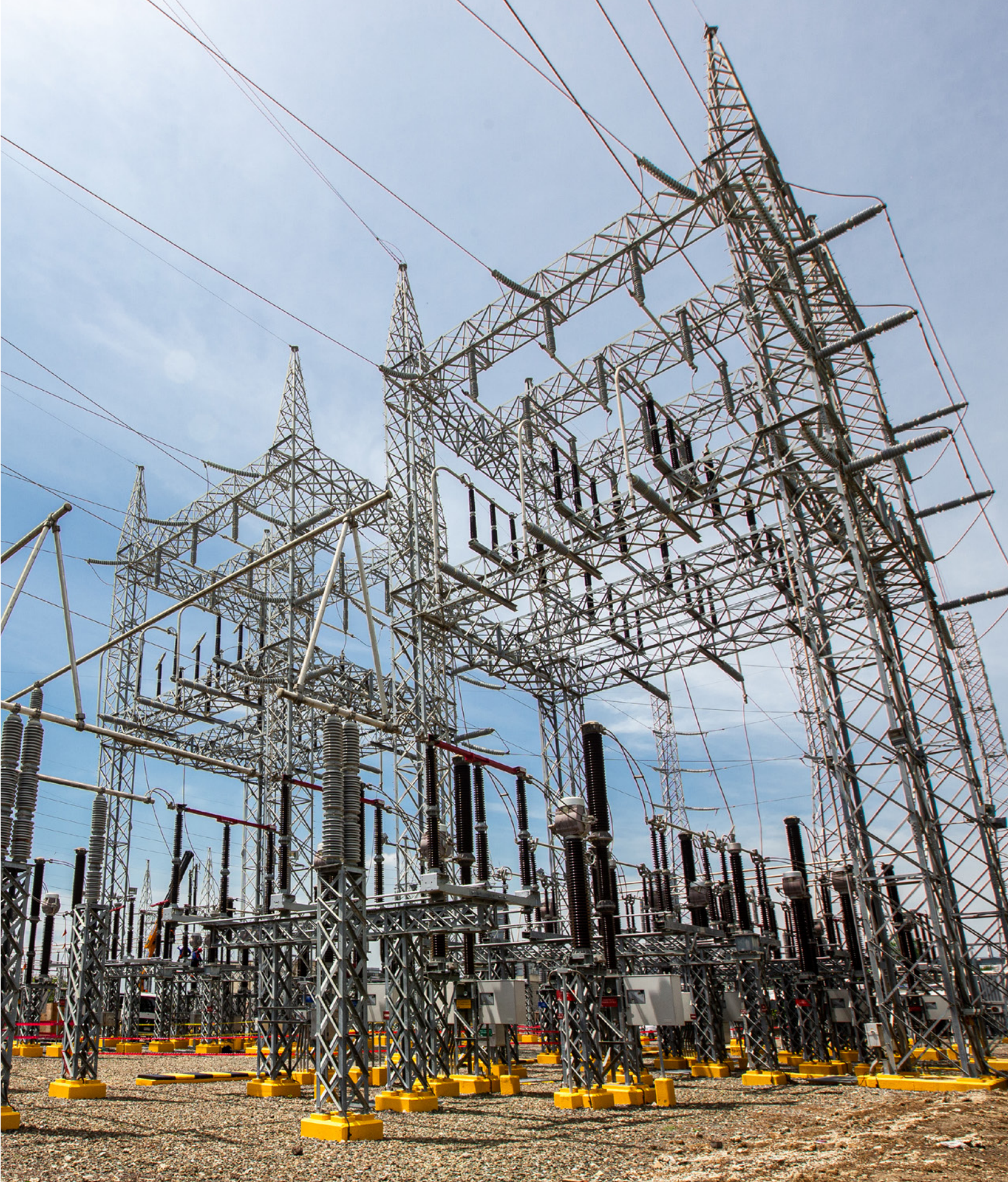
Subestación Termocandelaria. Cartagena.
